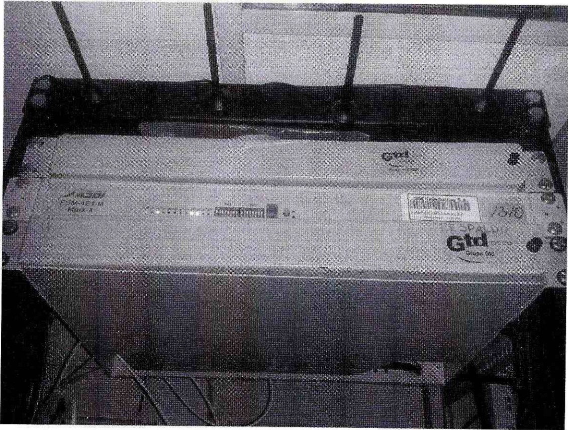
Fotografía N° 8 Dispositivos de respaldo GTD.
